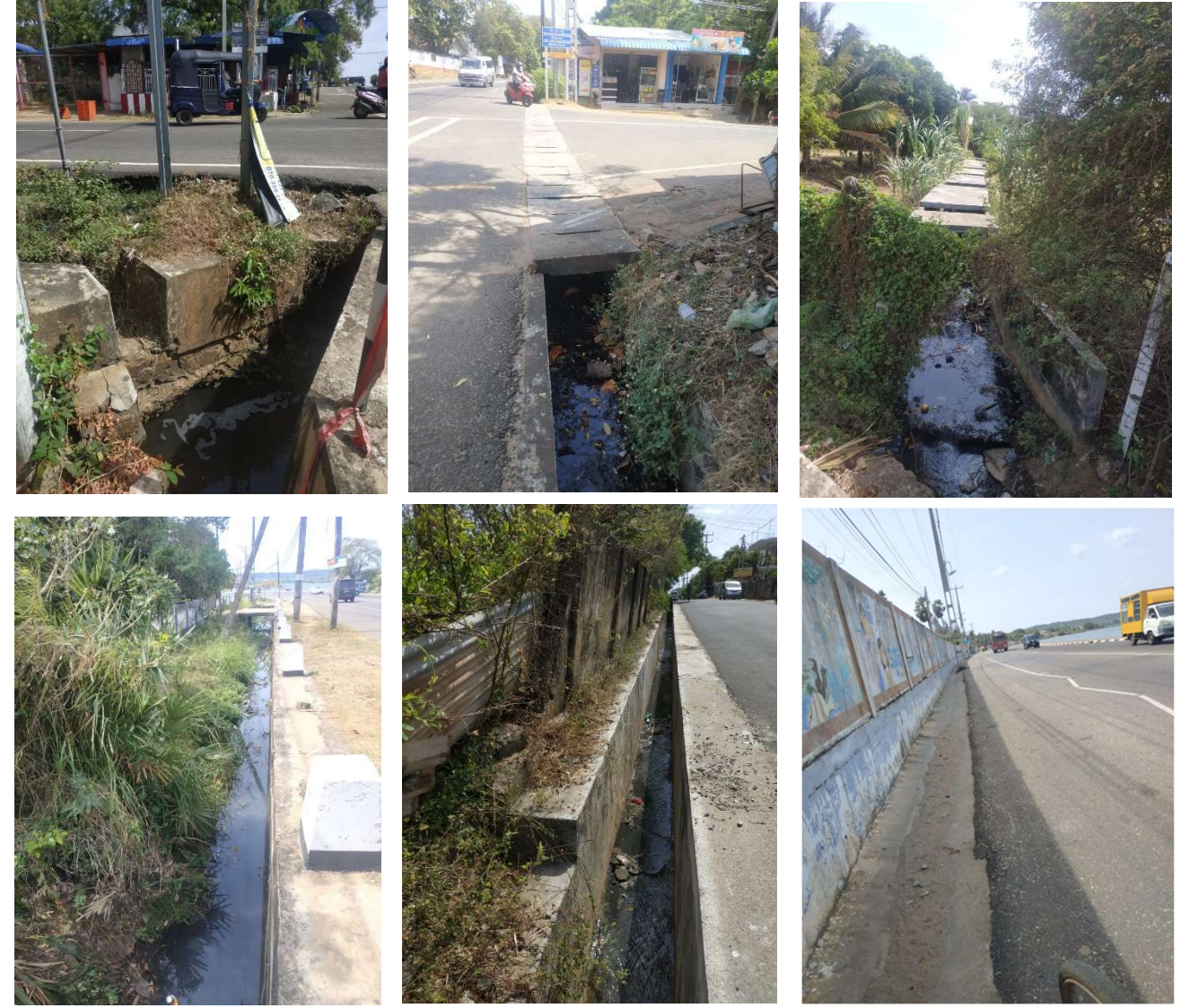
உரு 6-16: (அ) வலிவிடு விநாயகர் ஆலயத்திற்கு முன்பாக உள்ள வீதியோர வடிகால் (ஆ) விகாரை வீதிக்கு முன்பாக உள்ள வடிகாலில் திண்மக்கழிவுகள் அகற்றப்பட்ட அல்லது வடிகட்டப்பட்ட வாய்க்கால் (இ) சிறுவர் பூங்காவிற்கு அருகில் பகுதியளவில் மூடப்பட்ட வடிகாலின் ஒருபக்கம் இடிந்து விழுந்தது (உ) சிங்கள மகா வித்தியாலயத்திற்கு அருகிலுள்ள கடல் காட்சி வீதி மற்றும் உள் துறைமுக வீதி சந்தி (ஊ) சிங்கள மகா வித்தியாலயத்திற்கு முன்னால் உள்ள வடிகாலின் ஒரு பக்கம் இடிந்து விழுந்தது.
